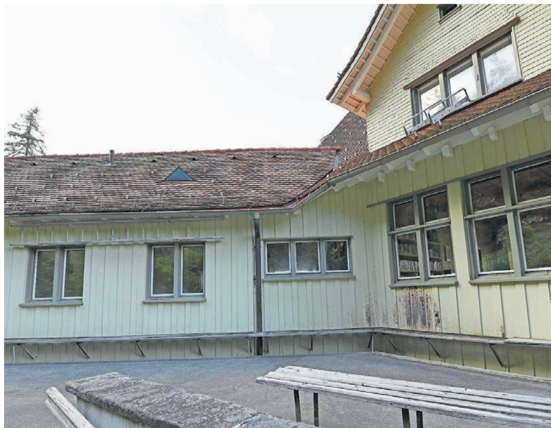
Die Brandspuren sind an der Fassade sichtbar.
